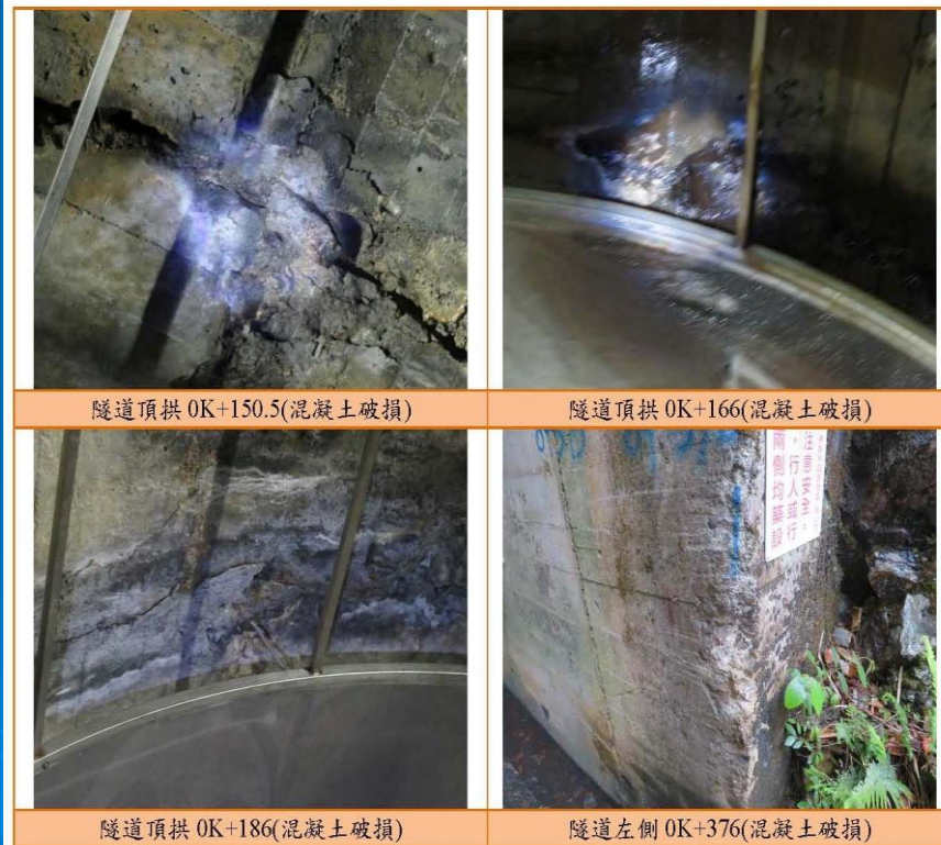
圖 4-1-50 隧道內其他異狀照片(1/2)
